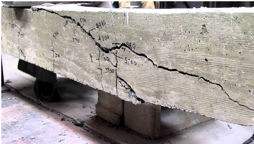
1.6 - сурет – Жарылған бетон конструкциясы
